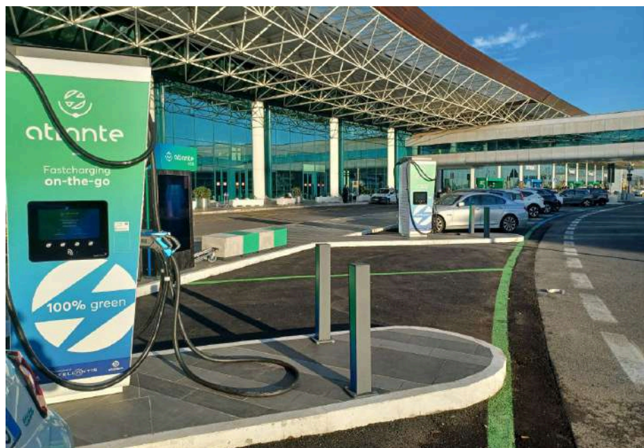
L'INFRASTRUTTURA DI RICARICA INAUGURATA DA ATLANTE PRESSO L'AEROPORTO DI ROMA FIUMICINO. LE COLONNINE DEL CPO UTILIZZANO ENERGIA PROVENIENTE AL 100% DA FONTI RINNOVABILI
