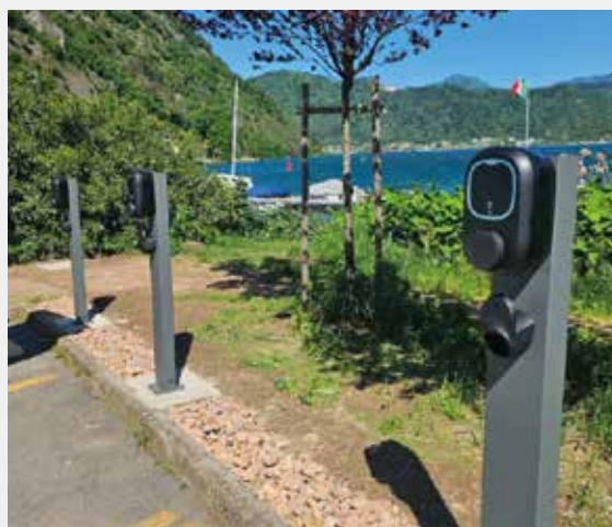
UNA RECENTE INSTALLAZIONE REALIZZATA DA ELIOSTECH SUL LAGO MAGGIORE: 3 PUNTI RICARICA WALLBOX PULSAR PRO SOCKET DA 22 KW
